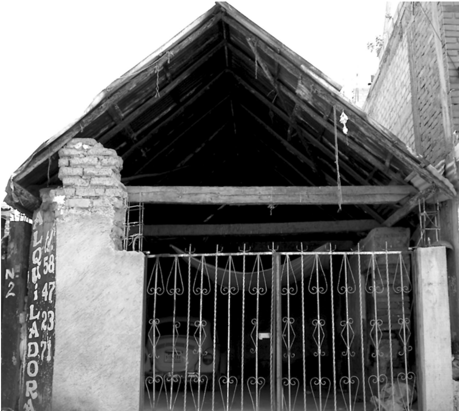
Imagen 5 Antigua casa de adobe, hoy utilizada como cochera. Se aprecia el interior de la antigua vivienda. (Localizada en la calle Insurgentes del barrio de Los Reyes. Imagen tomada por Ricardo Flores Cuevas el 4 de julio de 2010.)
